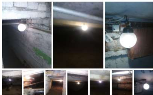
29.11.2021 Освещение подвальных помещений г. Пушкин, Ленинградская ул. 73 #жко2пушкин
