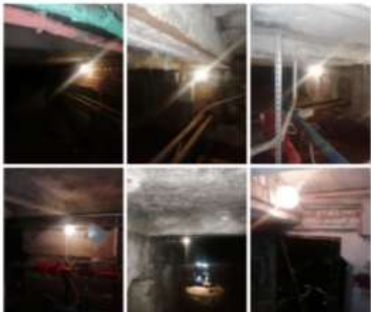
29.11.2021 Освещение подвальных помещений г. Пушкин, Ленинградская ул. 69/81 #жко2пушкин
